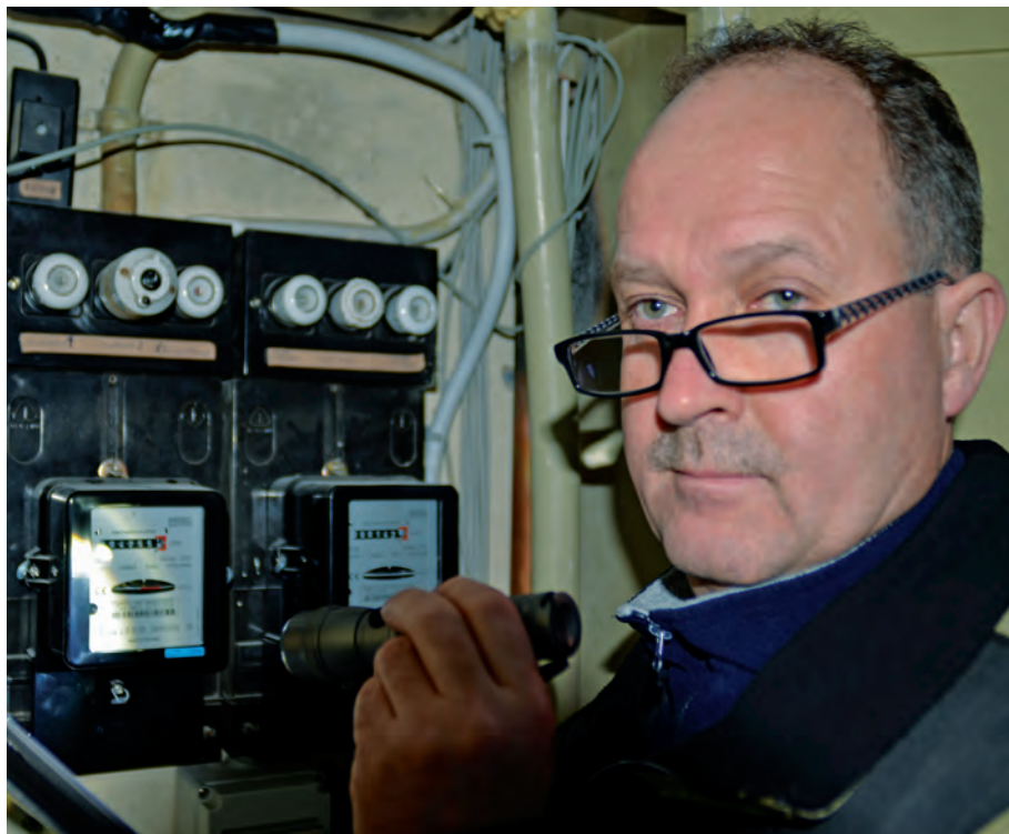
Unser neuer Hauswart Frank Krüger beim turnusmäßigen Überprüfen der Zählerstände
